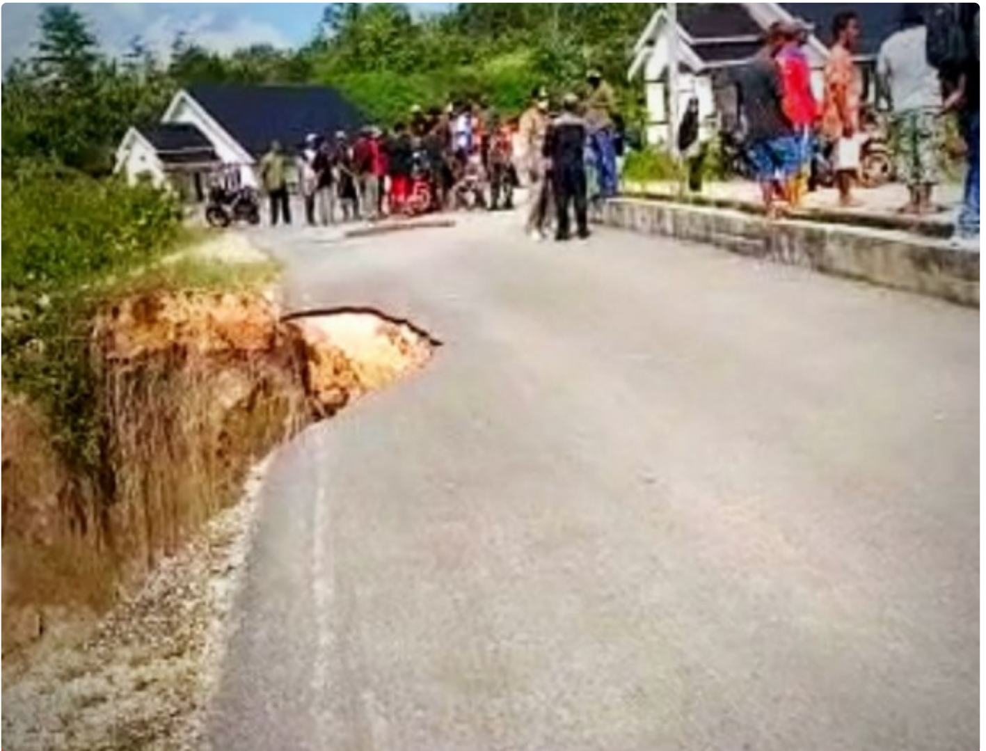
Lokasi Abrasi Jalan Utama Perkantoran Daerah Buton Selatan, Kelurahan Masiri.
